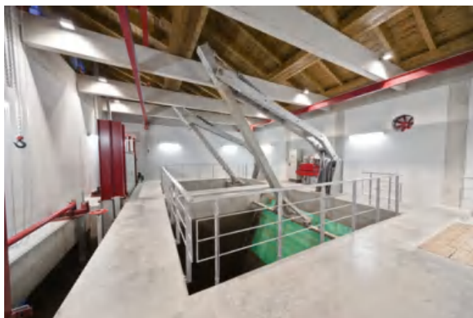
Fig. 15.33 Trash rack room of the SHPP Železný Brod powerhouse (source Vodní elektrárna Železný Brod, a.s.)
